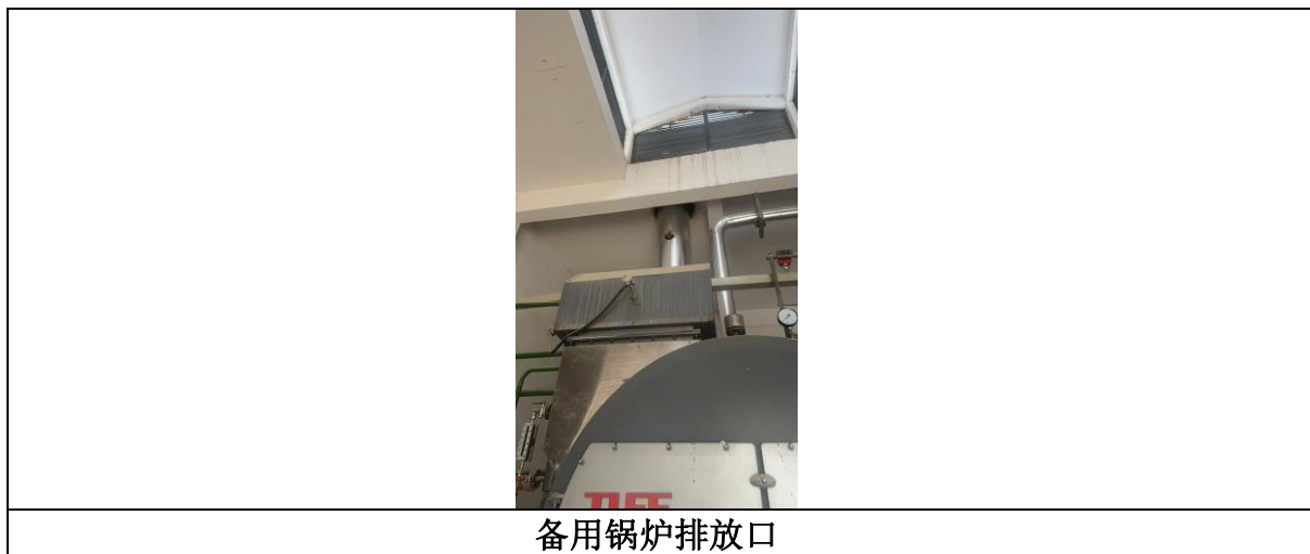
图4-4 废气处理设施及排放口照片
